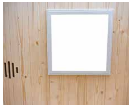
Eclairage LED au plafond
