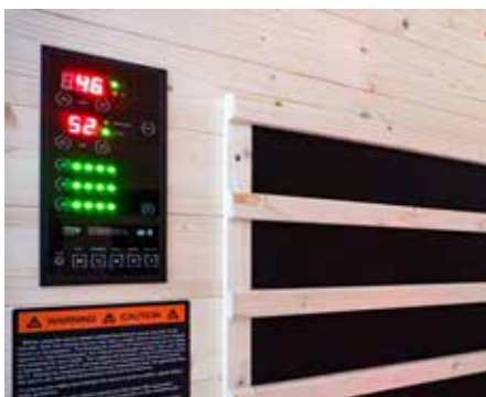
Panneau de contrôle intérieur
